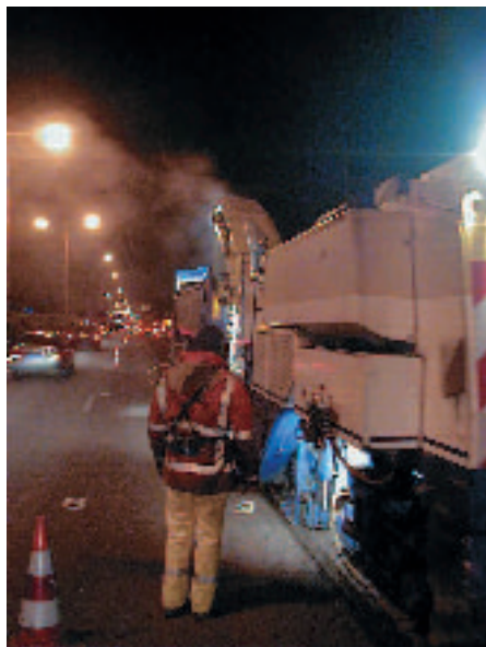
Trabajadores expuestos a sustancias peligrosas.
